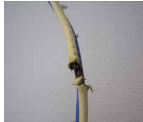
配線皮膜劣化
