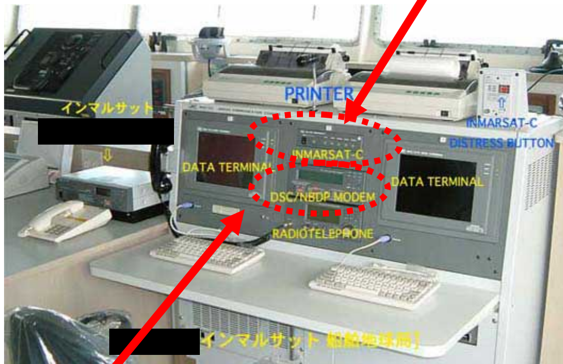
インマルサット遭難警報装置
