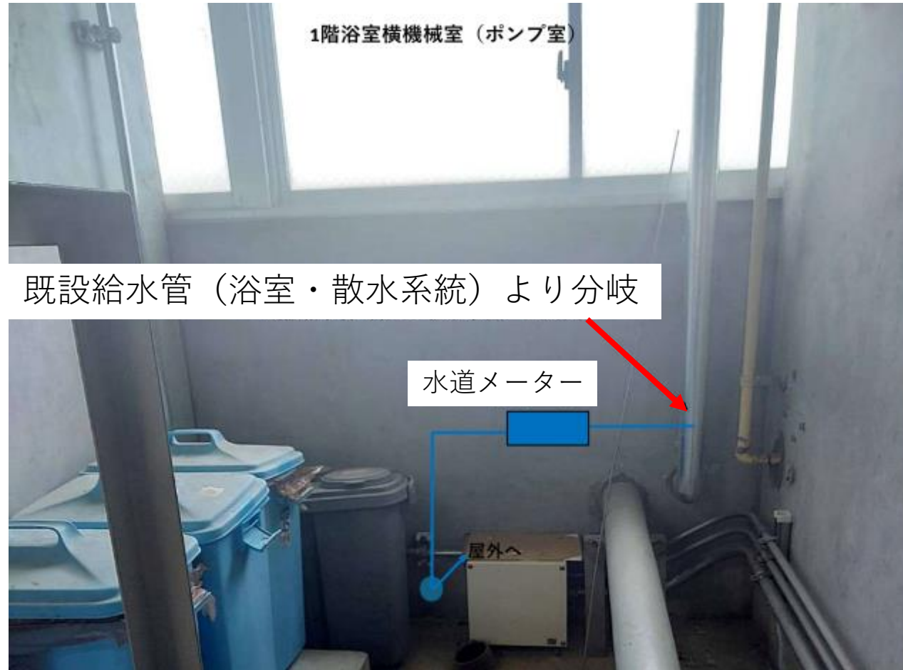
写真⑧1階浴室機械室（ポンプ室）
