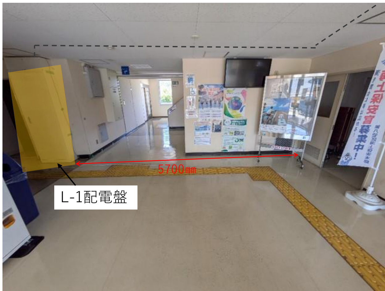
写真⑪ 1 階ホール配電盤
