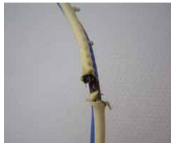
配線皮膜劣化
