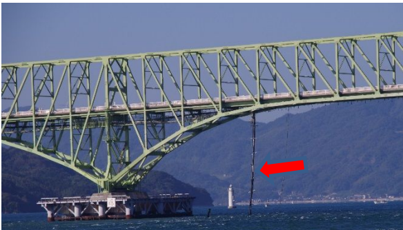
衝突により海面に垂れ下がった水道管
