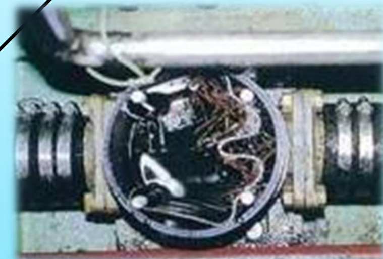
海水こし器の詰まり
