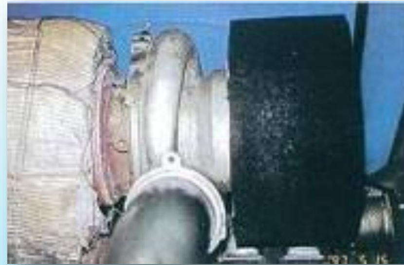
エアフィルターの詰まり
