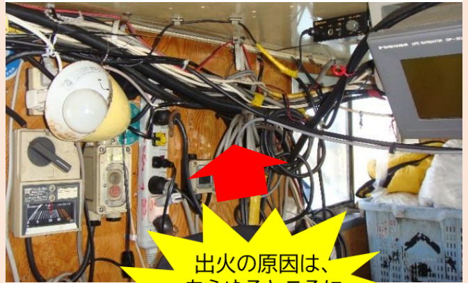
乱雑した配線状況 (船橋内の状況)
