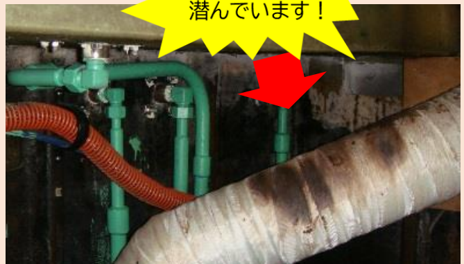
排気ガス漏れによる保護材の焼付き(機関室内)
