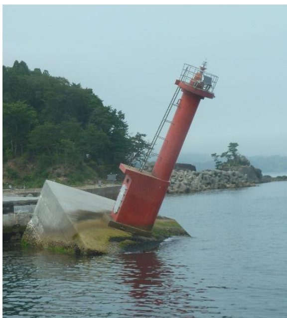
■被災した陸前長崎港防波堤灯台
