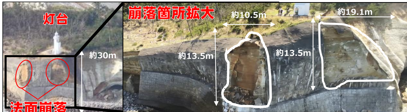
令和4年4月28日現在 ドローンによる計測で約300㎡の法面が崩落していることが判明しています。
