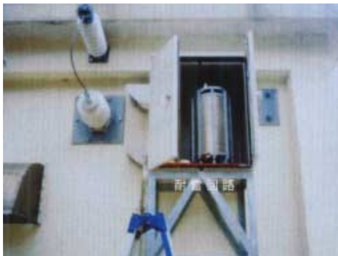
室外型耐雷回路設置状況写真
