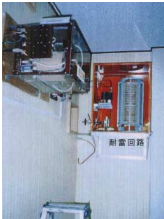
室内型耐雷回路（メーカー品）設置状況写真
