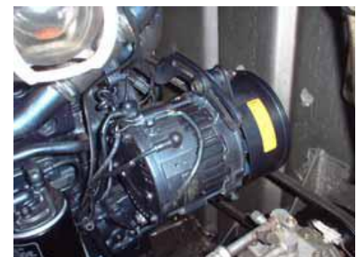
発電機（オルタネーター）
