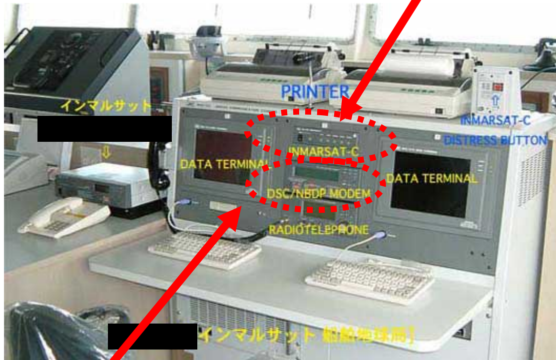
インマルサット遭難警報装置
