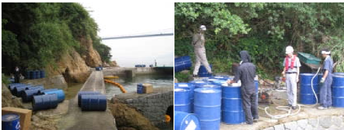
「燃料(軽油)はドラム缶で人力にて陸揚げし、その後、エンジンポンプで貯蔵タンクに送油します」
