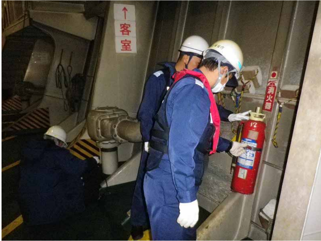
消火設備の点検状況
