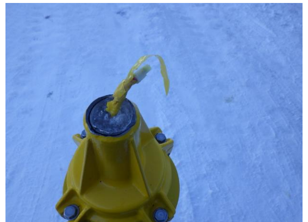
波によりちぎれた仮灯の破断面
